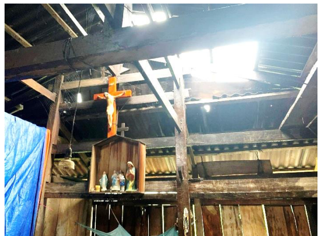
The roof was gone (Mái nhà bị bão thổi bay)
