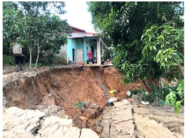
Landslide (Đất sập)
